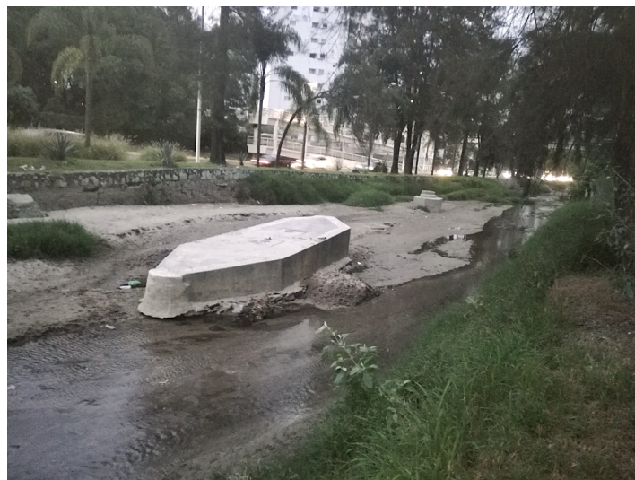
Figure 15. Sewers and manholes inside the Patria Avenue canal. Figura 15. Registros y pozos al interior del canal de Avenida Patria.
